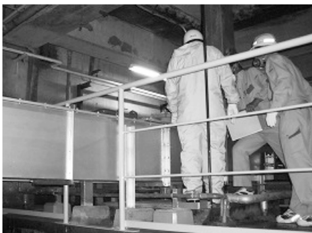
▲スクリーンコンベヤー (清掃センター)
