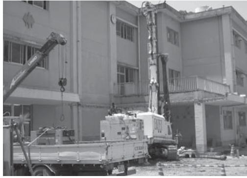
▲天城小学校開校に向けた増改築工事が始まった狩野小学校
