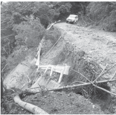
▲台風による崩落(土肥地区林道上池線)
