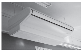
▲今年、土肥小学校にはエアコンが設置されました
