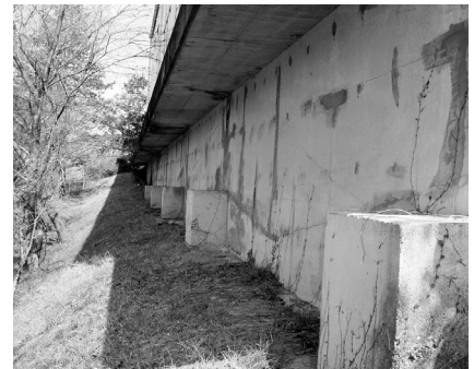
今夏から耐震補強工事が始まる 天城中学校体育館（北側）
