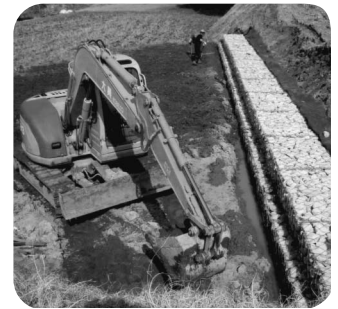
災害復旧現場
