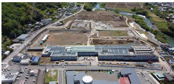
建設現場の航空写真 屋根がかかり、グラウンドの周囲には防球ネットの支柱が立ち始めています。
