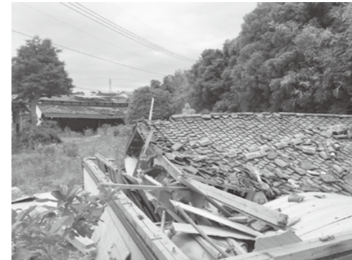
▲熊本地震で倒壊した家屋
