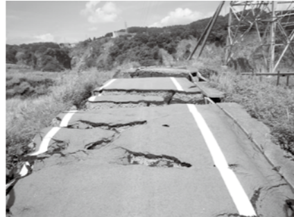
▲地震によって歪む道路
