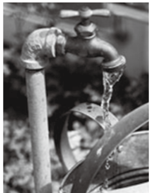
▲露出した水道管には保温材を付けましょう
