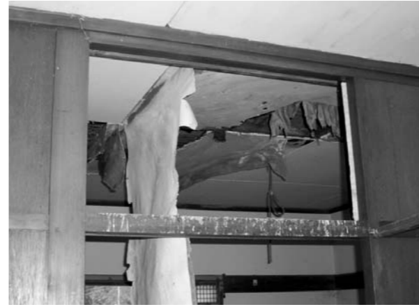
▲剥がれ落ちた天井
