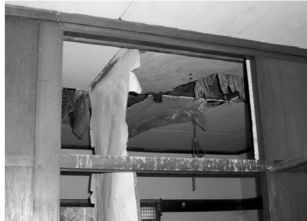
▲剥がれ落ちた天井
