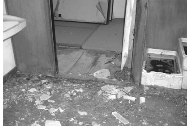
▲窓ガラスが割れ、全ての部屋の畳がカビなどで腐敗している
