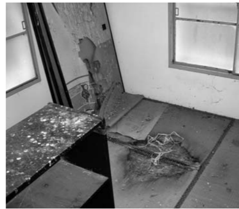
▲鳩の糞などで荒廃した部屋
