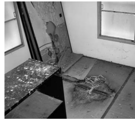
▲鳩の糞などで荒廃した部屋
