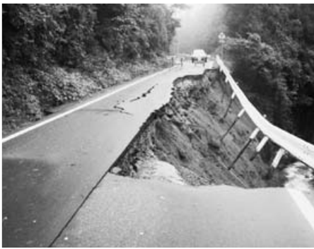
136号旧道被災状況
