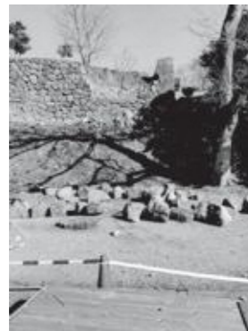
金沢城石垣の崩落
