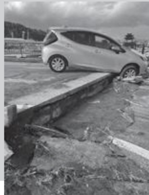
陥没・液状化
