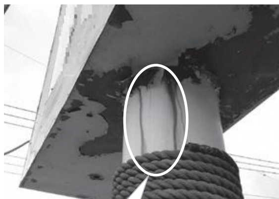
さび色の液体が垂れた跡(内部腐食の可能性)
