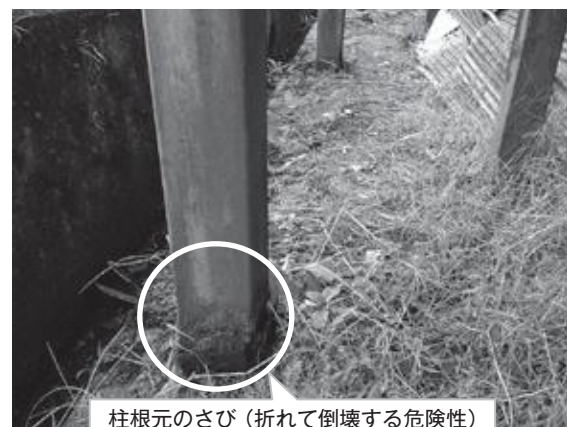
柱根元のさび(折れて倒壊する危険性)
