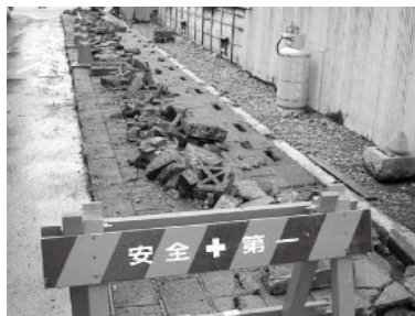
▲倒壊したブロック塀
