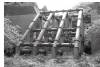
▲スリットタイプの砂防えん堤
