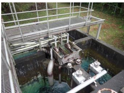
冷川浄水場(中伊豆)
