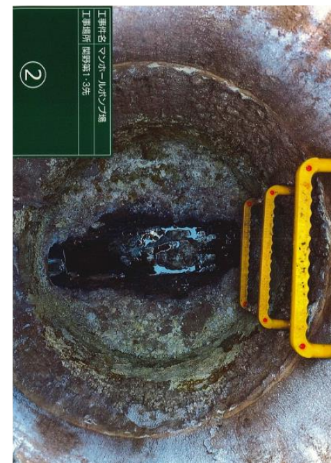
腐食がひどい 設備やマンホール
