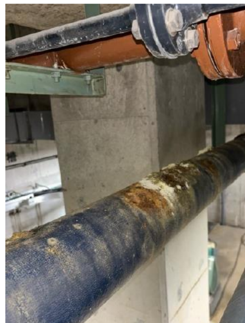
施設内配管の腐食 (湯ヶ島クリーンセンター)
