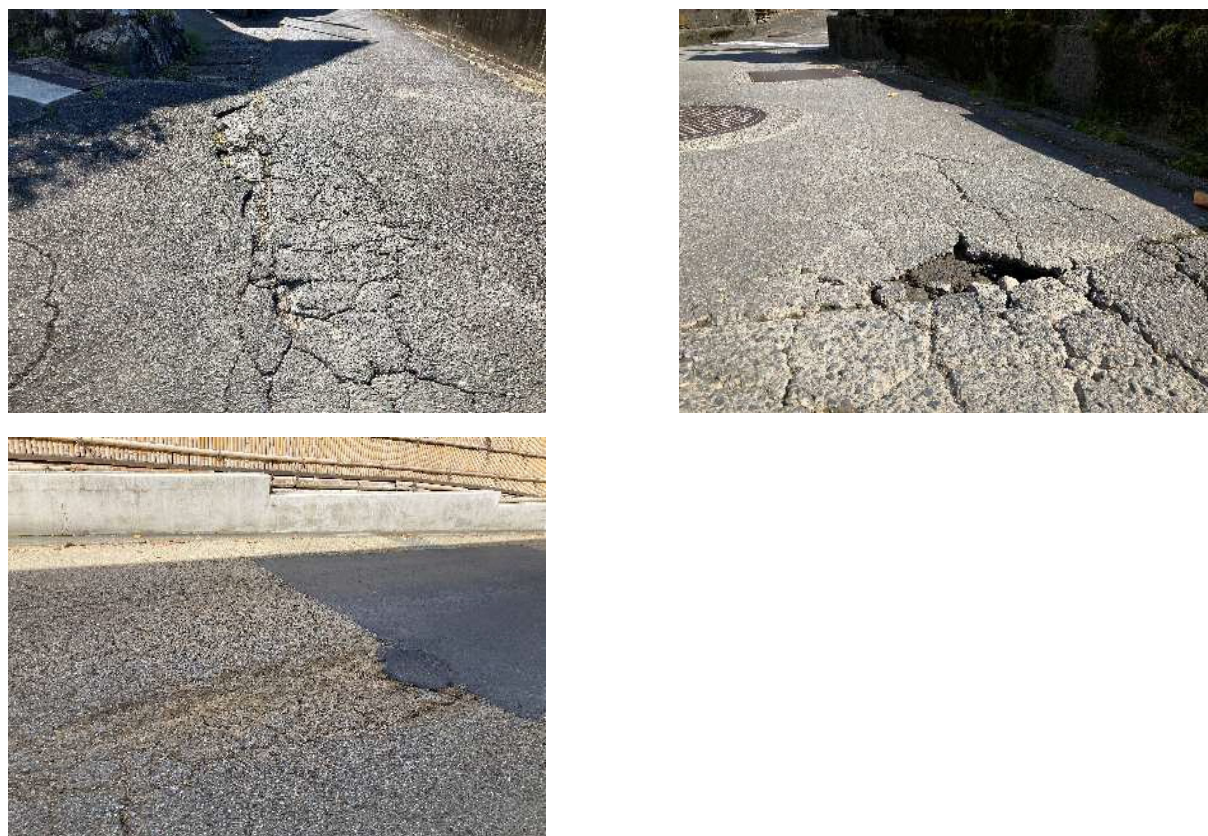
図 2-2 伊豆市の路面損傷状況例
