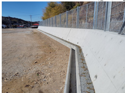
重力式擁壁及び落石防止柵
