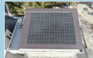
▲管理棟太陽光発電
